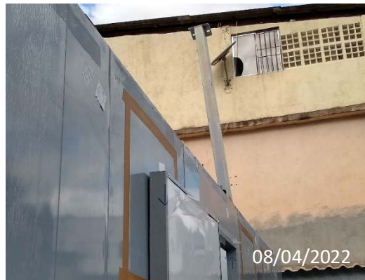
FIGURA 8 — Pontaete empenado durante a montagem do telhado
